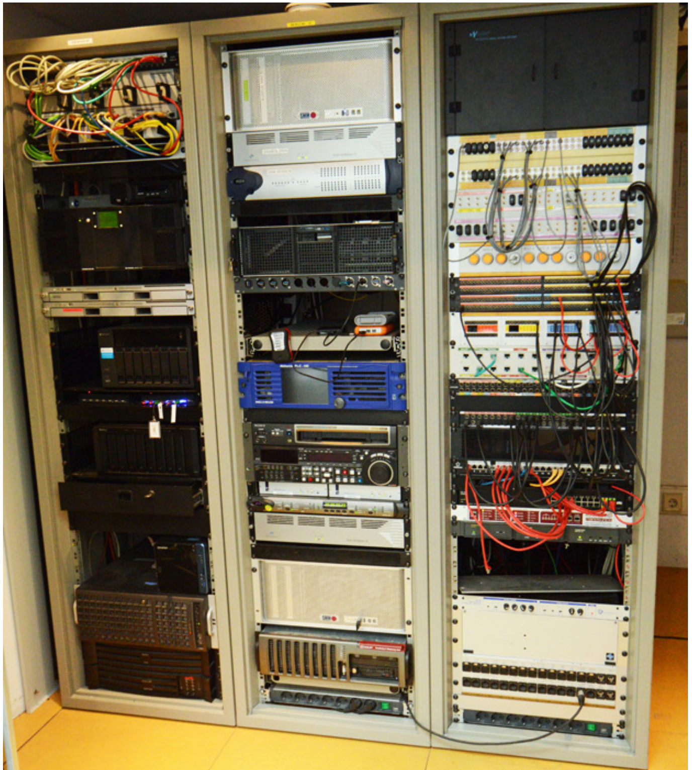
[Foto: zentraler Maschinenraum der MSM Studios]
