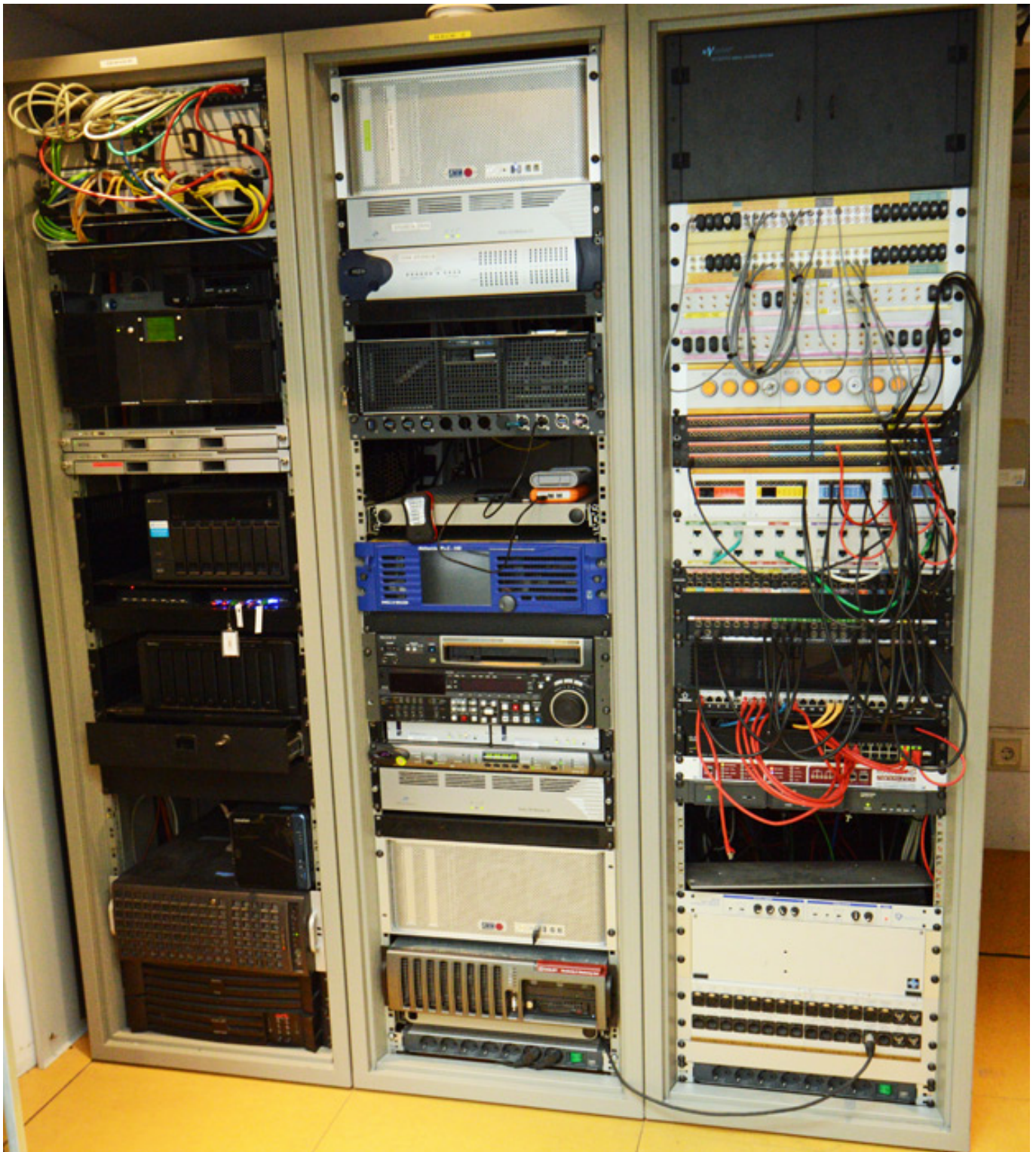
[Foto: zentraler Maschinenraum der MSM Studios]
